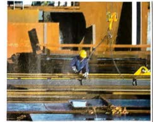
In Zukunft soll das manuelle Anschlagen durch den Einsatz von Magnettraversen ersetzt werden – die Voraussetzungen dafür hat die neue Krananlage bereits. Foto: StahlCraneSystems
