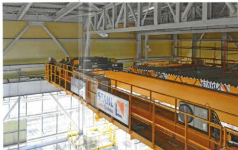
01 为确保工厂顺利运行，共有来自Stahl Cranesystems的11台起重机，6台钢丝绳葫芦和30台手拉葫芦被应用。
