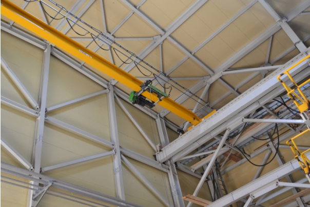
单梁桥式起重机在世界第三大化肥厂内的应用。
